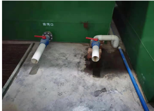
放射性废水衰变池取样口
