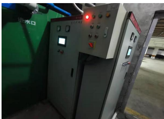
放射性废水衰变池自动控制系统
