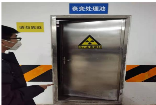
放射性废水衰变池
