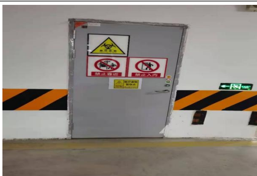
医疗废物暂存间
