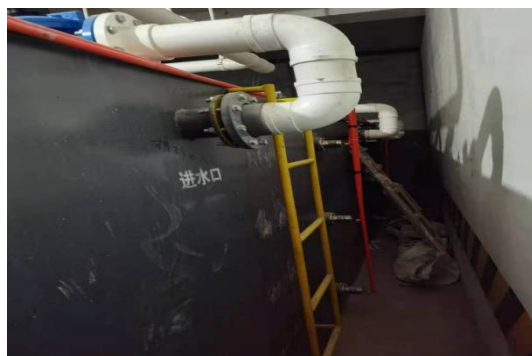
放射性废水衰变池
