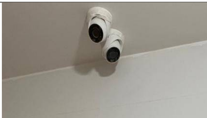
贮源室闭路监视系统
