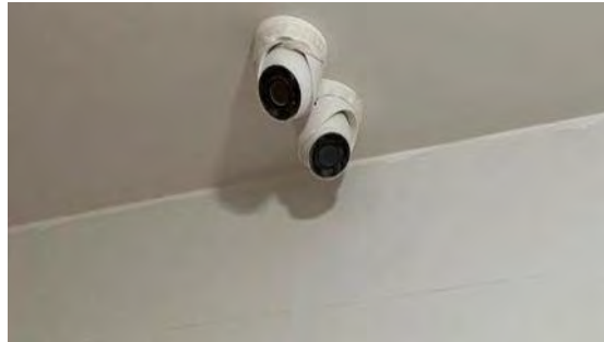
贮源室闭路监视系统
