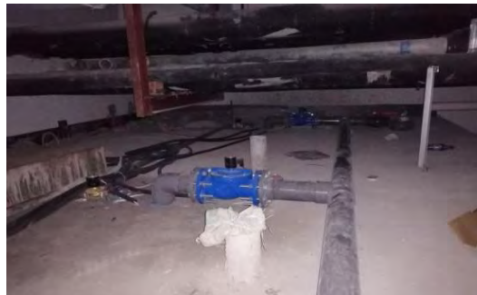
衰变池排水管
